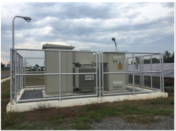
หม้อแปลงไฟฟ้า (Transformer)
