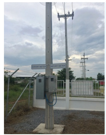
มิเตอร์วัดจำนวนหน่วยไฟฟ้า (Meter)
