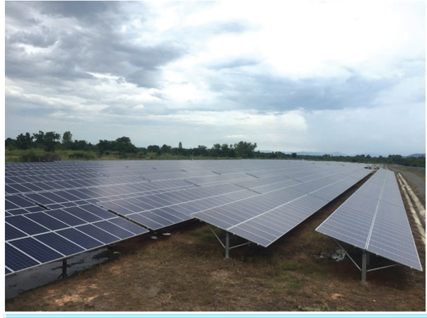
โรงไฟฟ้าพลังงานแสงอาทิตย์ปริมาณพลังงานไฟฟ้าเสนอขายตามสัญญาซื้อขายไฟฟ้า 2.0 เมกะวัตต์
